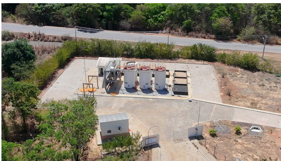
Figura 71 - Estação de tratamento de efluentes - ETE do CRES.
