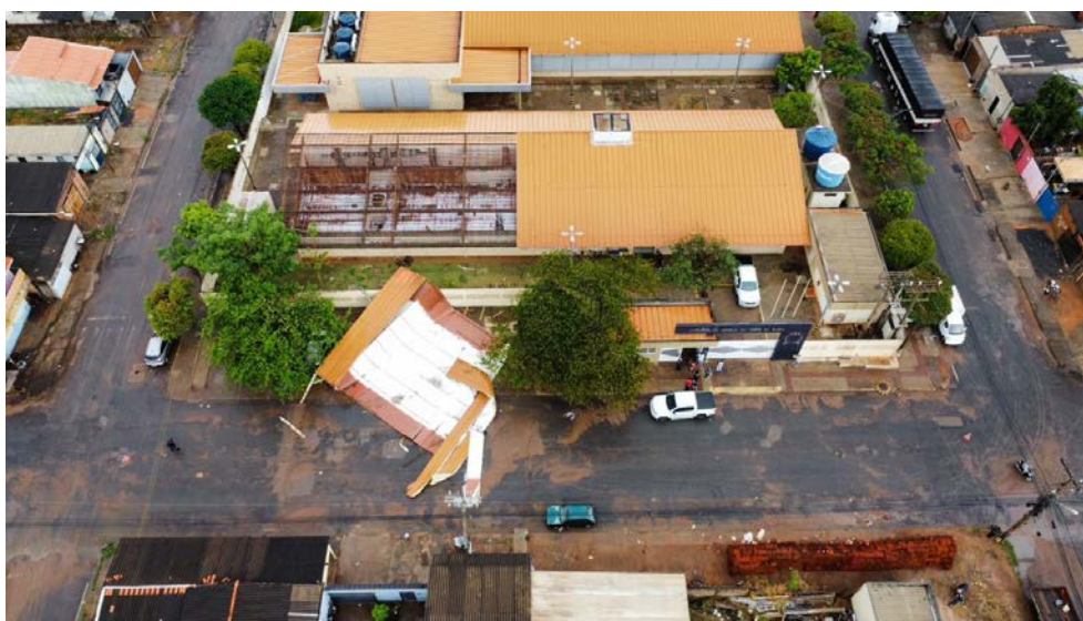
Figura 114 - Parte do telhado do CMLEM arrancado pela força do vento.
