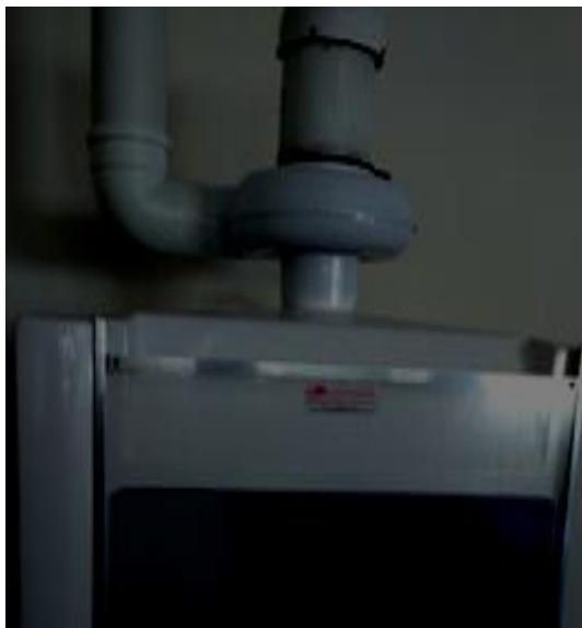
Capela de exaustão para produtos químicos
