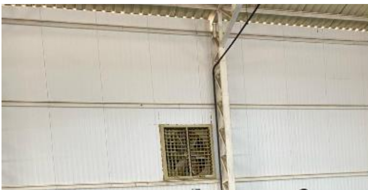
Figura 6 - Ventilador do RUP sem funcionar
